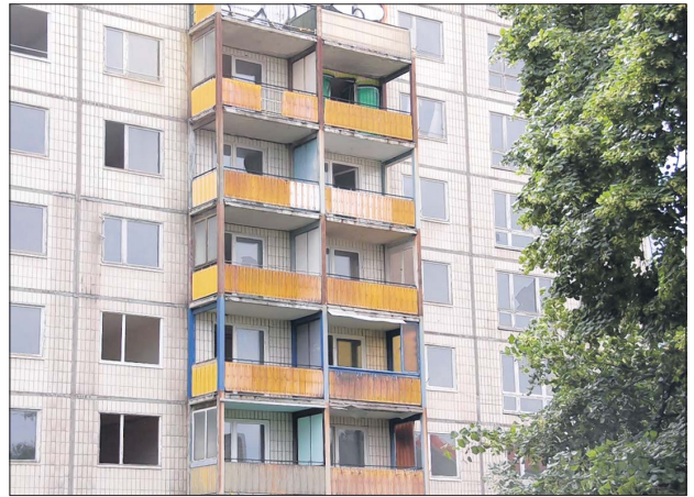
Die Balkone sind rostig, die Fensterscheiben kahl, der Wohnblock in der Agnetenstraße kein Hingucker in Alte Neustadt. Fördermittel für den Abriss wurden bewilligt.
