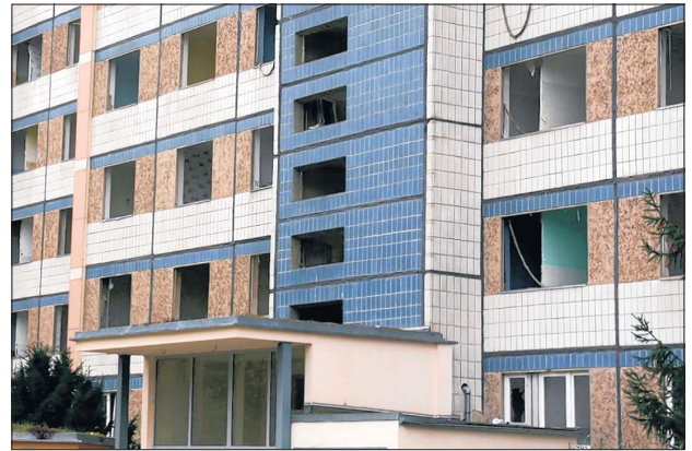
Der Zehngeschosser Im Brunnenhof 4 bis 7 steht seit Jahren leer. Aktuell hofft die Wobau, im Frühjahr 2010 mit dem Abriss beginnen zu können. Die Bewilligung für Fördermittel aus dem Stadtbau-Programm fehlt noch.
