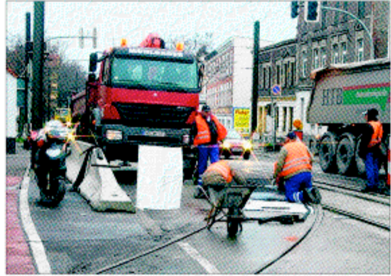
Für lange Rückstaus in Spitzenzeiten sorgt diese Baustelle auf der Sülzebrücke in Salbke. Es gibt keine Vorwarnung für Kraftfahrer.
