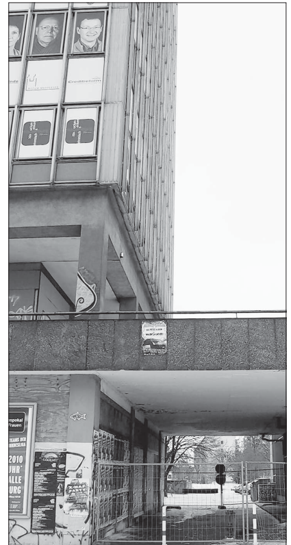
Der Durchgang am Haus der Lehrer ist immer noch gesperrt. Während der Frostperiode waren Trümmer auf dem Gehweg gelandet. Ein Statiker soll nun das Gebäude prüfen. Foto: Jana Halbritter
