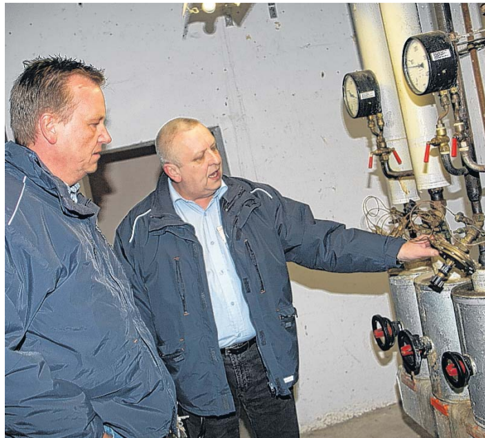
Concierge Bernd Lampe erklärt Burkhard Lischka (vorn) die Heizungsanlage.
