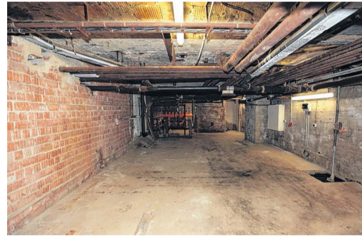
Der Heizungskeller stand komplett unter Wasser, die Sanierung ist fast abgeschlossen. Fotos (2): MVGM/Müncheberg
