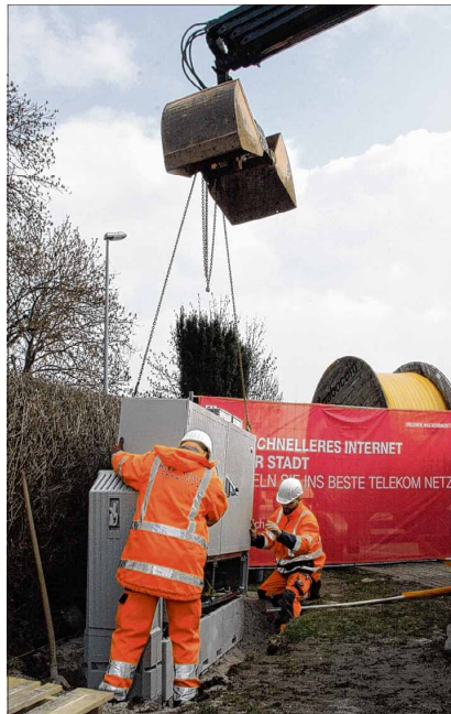
Die Telekom baut in Magdeburg-Nord das Glasfasernetz für schnelles Internet aus. Gestern stellten Peter Friedrich (l.) und Kevin Kegel einen Verteilerkasten an der „Spinne“ in Nordwest auf. Foto: Harter
