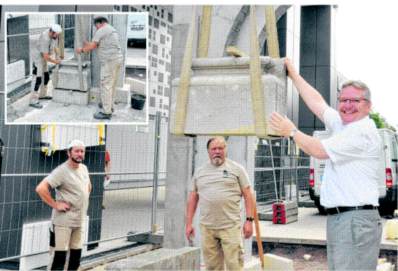
Kuratoriumsvorsitzender Klaus Zimmermann legt bei der Verlegung des ersten Steins für das Katharinenportal selber Hand an. Mitarbeiter der Firma Paul Schuster bringen den Stein anschließend an die richtige Stelle. Fotos: Klimek
