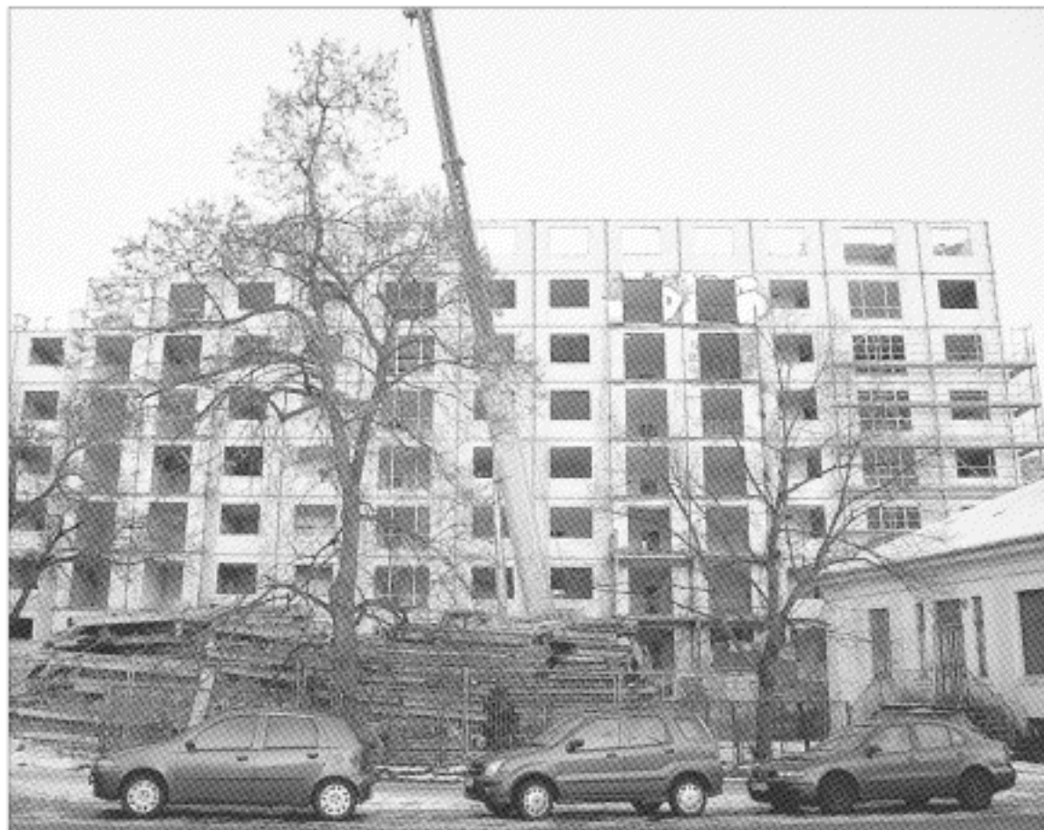
Bis Ende Februar wird das Hochhaus in der Agnetenstraße auf die sechste Etage zurückgebaut. Anschließend macht ein Abrisbagger den Achtgeschoss dem Erdboden gleich. Foto: Jana Halbritter
