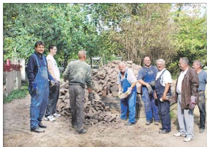
Während eines Arbeitseinsatzes sind am Wochenende die zum Wiederaufbau benötigten Steine gestapelt worden. Foto: privat
