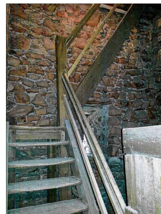
Der Zugang zum Glockenturm ist derzeit für Besucher sicherheitsbedingt gesperrt. Die alte marode Holzterrasse muss saniert werden.
