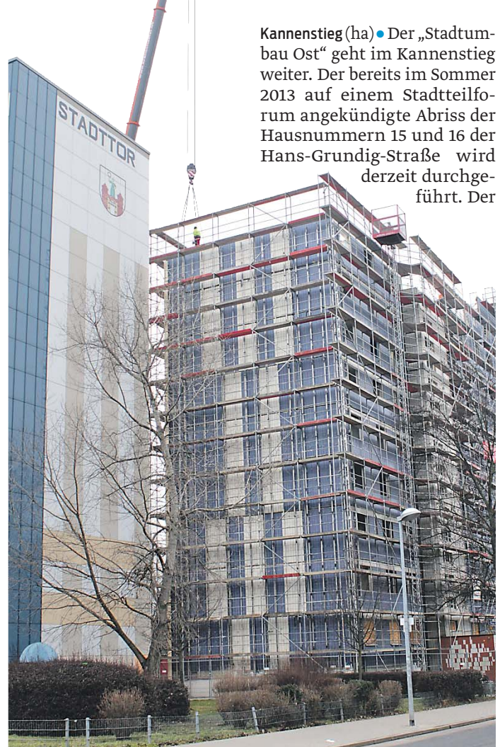
Bis Ende April werden die beiden Hauseingänge 15 und 16 der Hans-Grundig-Straße Geschichte sein. Die Wobau lässt sie derzeit im Rahmen des „Stadtumbau Ost“ abreißen. Foto: Ariane Amann
